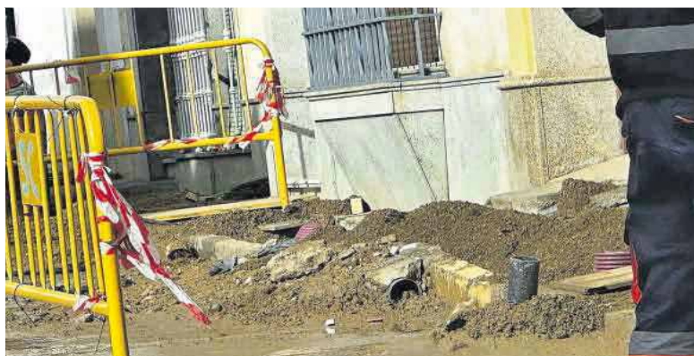
Rotura de tubería en la calle Ricardo Romero.
