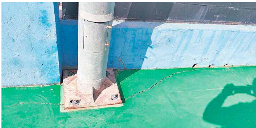
Una imagen de la grieta en la base del foco de doce metros de altura, que se tambalea presentando peligro.
